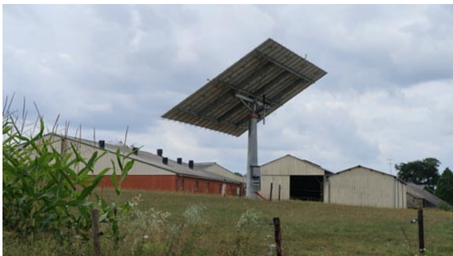
Panneau photovoltaïque orientable (tracker) dans une exploitation agricole à Moutiers.
