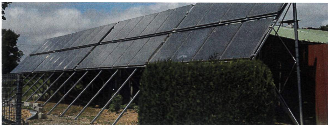
Installation solaire thermique pour un élevage de veaux de boucherie à Val d'Izé – EARL Les 3 Soleils ; ADEME
