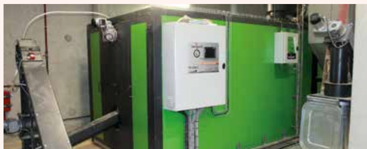
La chaudière biomasse de la nouvelle piscine à La Guerche-de-Bretagne va alimenter en chaleur plusieurs bâtiments périphériques.
